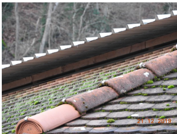
Abbildung 4: von außen sichtbare Spalten im Dachüberhang (21.12.2019)
